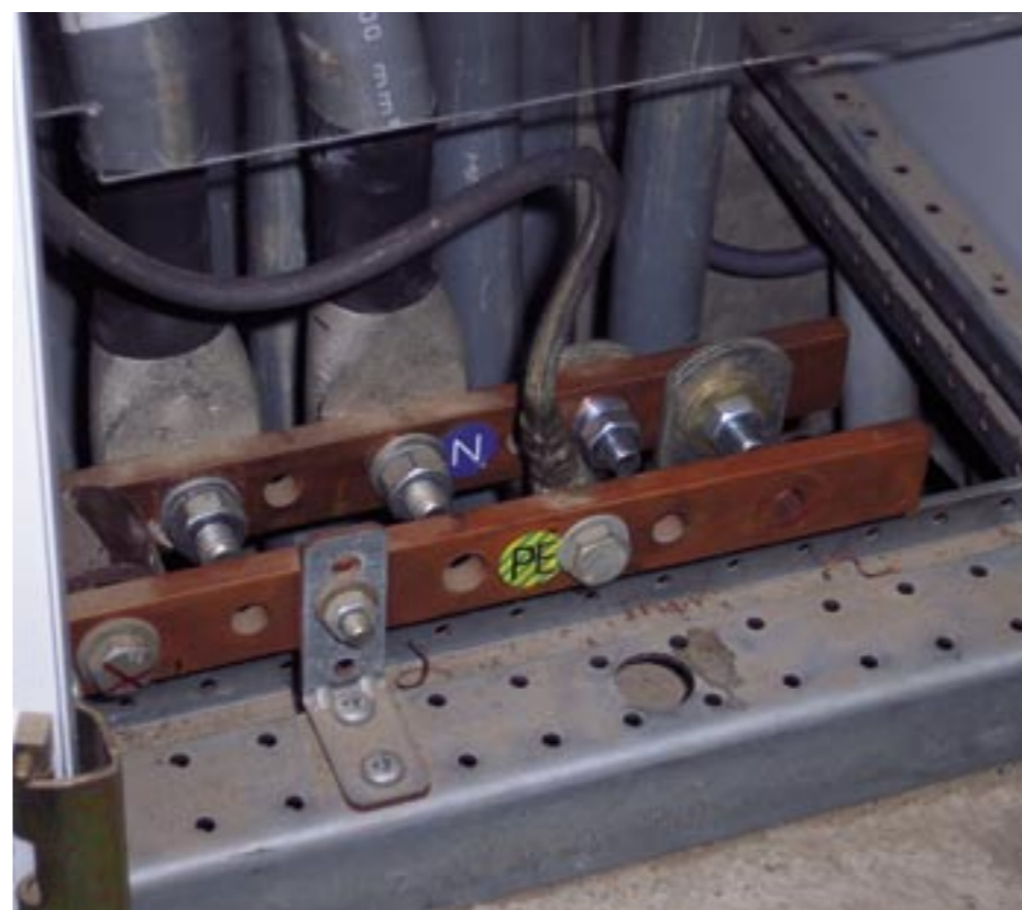
Nog vrij onbekend is dat tussen centraal filter en transformator géén aarde-nulverbinding mag bestaan. Anders is het filtereffect weg. De verbinding tussen de rails is hier dan ook verwijderd.
